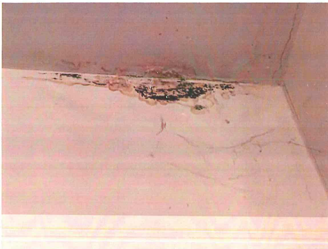
Plíseň na dívčích WC v jídelně z důvodu nefunkčního odvětrávání.
