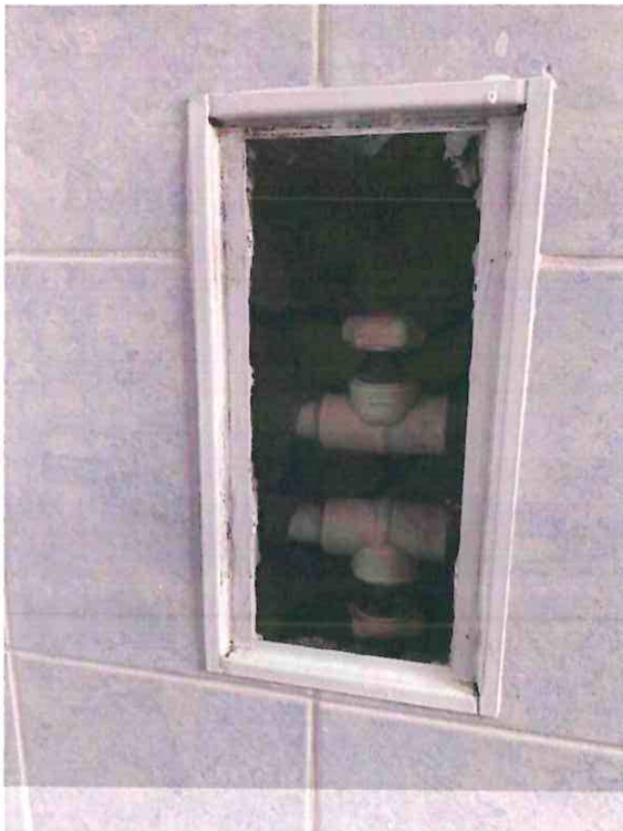
Chybějící kryty odpadních trubek na WC.
