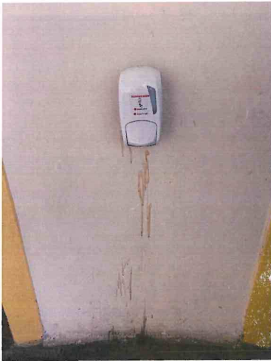
Znečištěná stěna mezi dívčím a chlapeckým WC.
