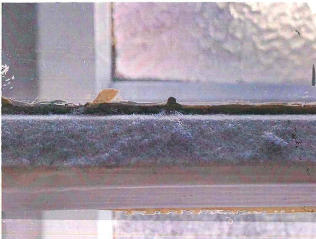
Příklad nedostatečného úklidu – vrstva prachu na oknech (stejný stav listopad 2022 i únor 2023).
