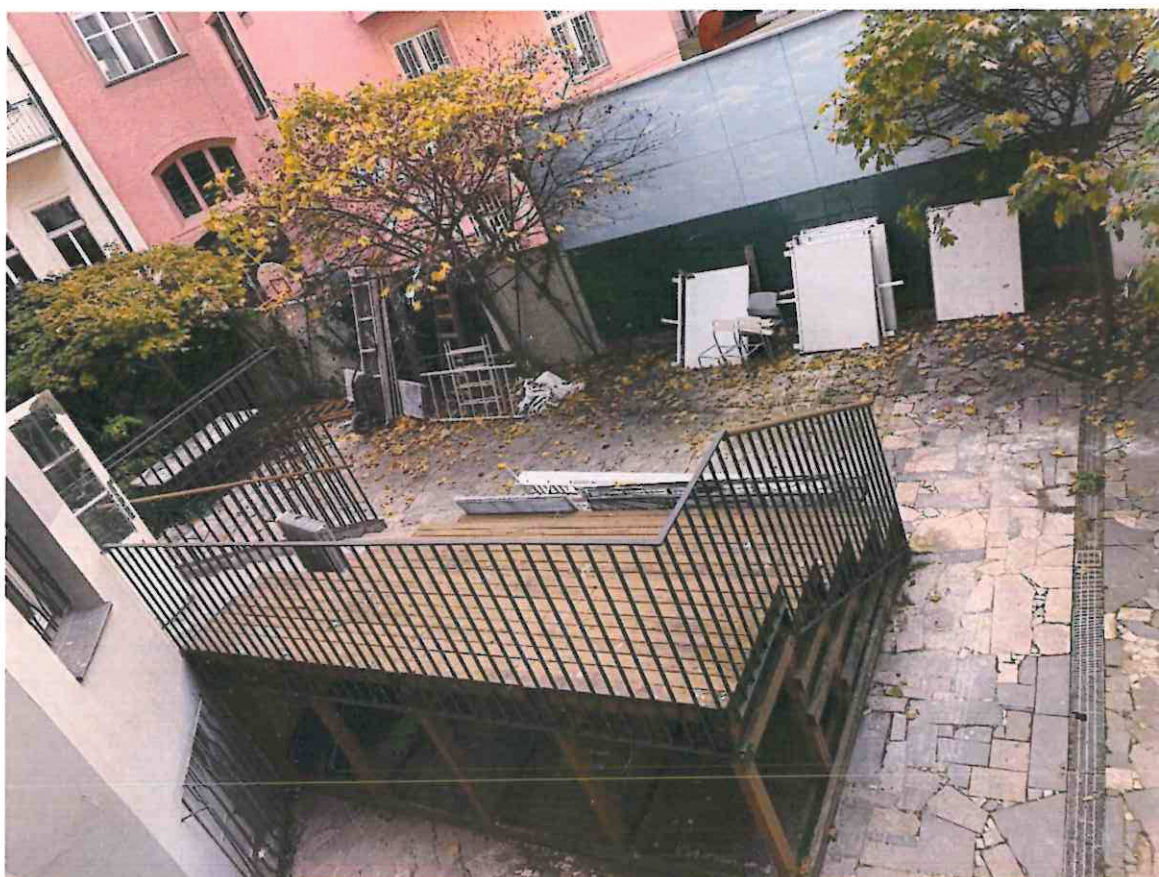
Dvoreček školy, dříve využívaný školní družinou – dnes i kvůli neopravené vnitřní fasádě „skladiště“.
