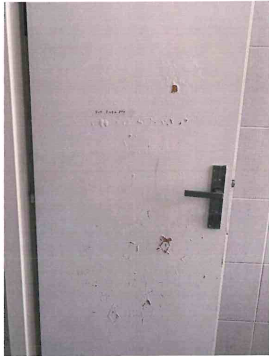
Stav dveří na toaletách.
