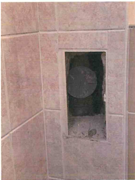
Chybějící kryt odpadních trubek (stav listopad 2022 I únor 2023).
