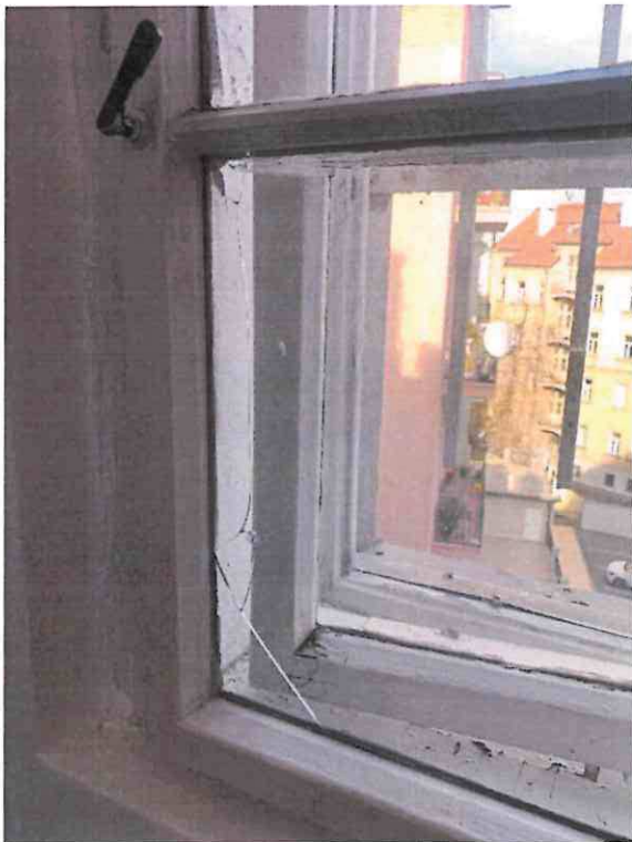
Rozbitá okna – na více místech.
