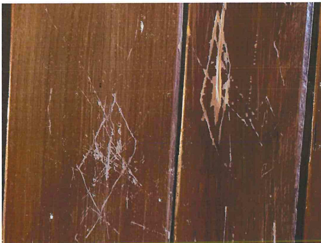
Stav dřevěného obložení ve vstupní chodbě k jídelně.
