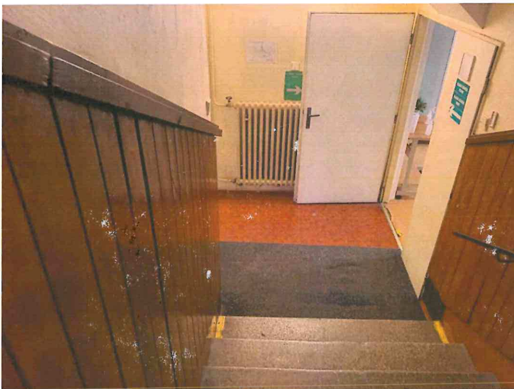
Vstup do školní jídelny – propadlá podlaha, na stropě zaprášené pavučiny, neumyté schody.
