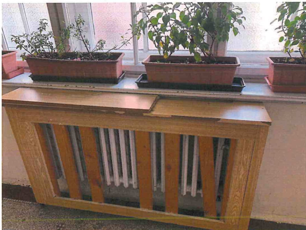
Poškozený kryt topení (stav z listopadu 2022 - v polovině února 2023 stále stejný, včetně volně položeného prkna s ostrými hranami, z jedné strany železná hrana).
