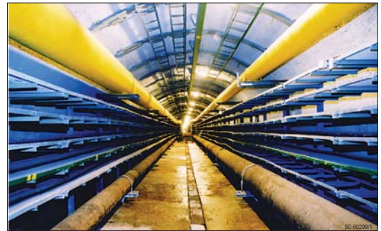
Podzemní kolektory ve kterých jsou uloženy optické sítě.
